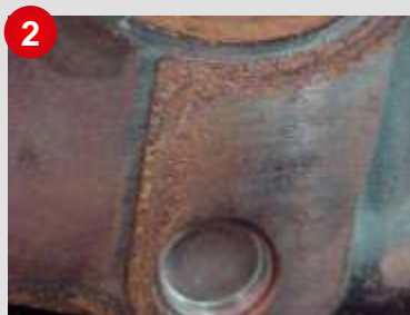
Corrosão na região da bomba d'água causada por água com tratamento inadequado
